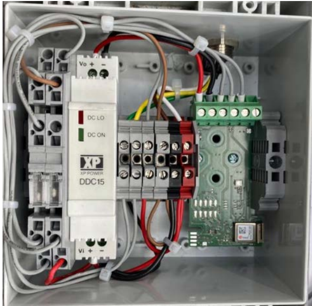
Abbildung 3: Bluetooth-Empfänger (LOC.id-System von RTB) für die Straßenbahn [Quelle: HAVAG]
